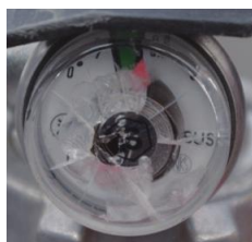
× 指示圧力計の損傷
