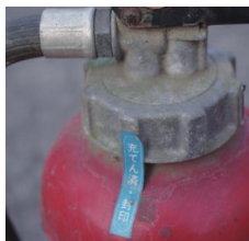
× キャップの劣化
