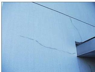
本庁舎外壁 ひび割れ
