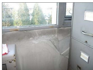
本庁舎内壁 ひび割れ
