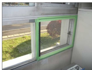
本庁舎 窓枠のゆがみ
