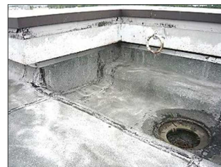
市民会館 屋上防水劣化
