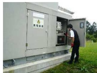
非常用発電機
