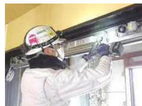
自動扉保守点検
