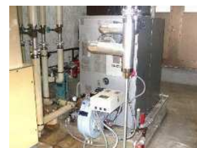
温水ボイラー
