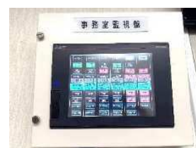
火葬炉監視モニター
