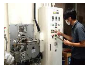
炉設備始業前点検
