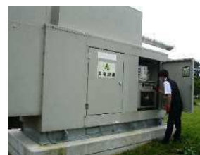
非常用発電機保守点検
