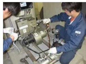
温水ボイラー保守点検
