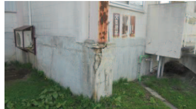
（コンクリートの剥離）
