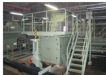
沈砂池 下水の中に含まれている大きなゴミや土砂を取り除きます。
