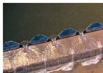
最終沈殿池 反応槽で増殖した活性汚泥を底に沈め、きれいになった水は減菌処理してから河川に流します。沈んだ泥は汚泥処理施設へ送られます。
