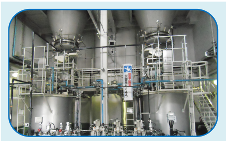
【粉末活性炭注入設備】
