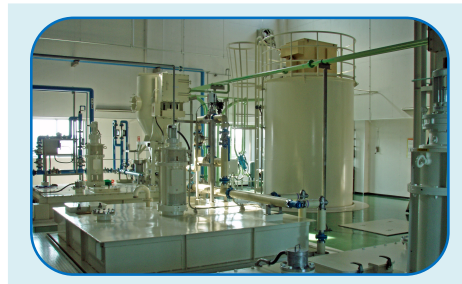
【消石灰注入設備】
