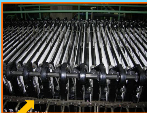
加圧脱水機上部
