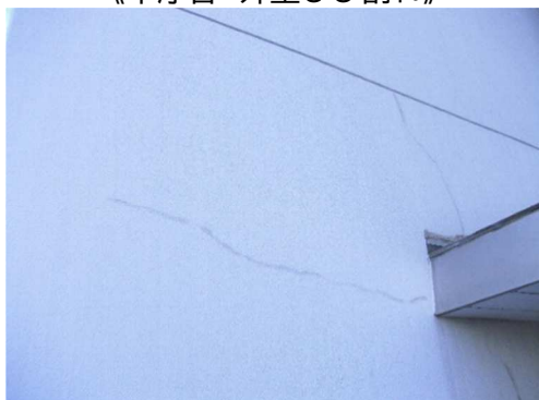
《本庁舎 外壁ひび割れ》
