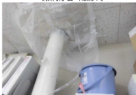
《教育庁舎 雨漏り》
