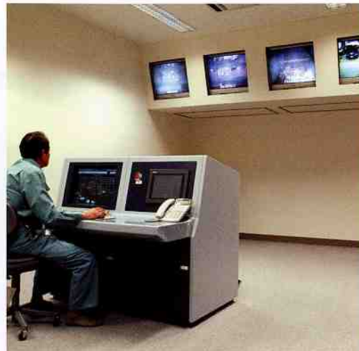
中央制御室 不燃・粗大ごみ施設の運転状況を監視・操作するところです。
