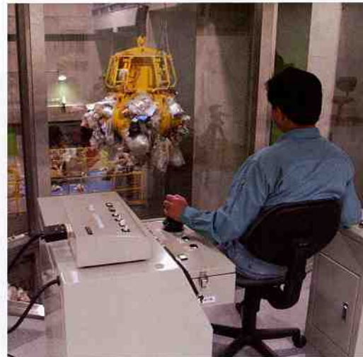
クレーン操作室 不燃・粗大ごみピットに貯留されたごみをクレーンで操作してホッパに投入します。
