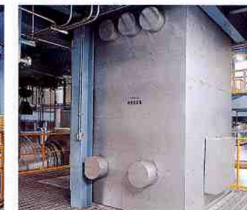
触媒反応塔 排ガス中の窒素酸化物とダイオキシン類を除去します。
