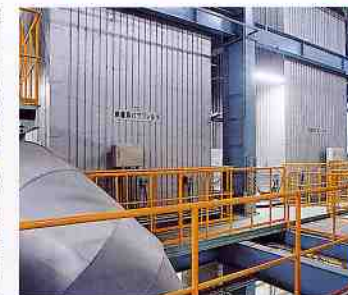
除塵用バグフィルタ・脱塩用バグフィルタ 除塵用バグフィルタで排ガス中の飛灰を取り除き、脱塩用バグフィルタで塩化水素と硫酸化物を除去します。
