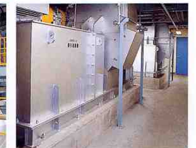
誘引送風機 有害なものを取り除いたクリーンな排ガスを煙突に送り出します。
