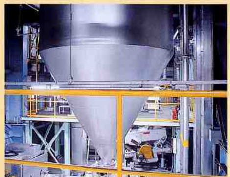
カーボン貯留ホッパ 燃焼溶融工程へ送るカーボンを貯留します。
