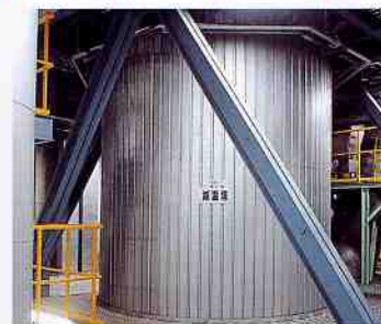
減温塔 排ガス中に水を噴霧して、約300℃の排ガスを約170℃に冷却します。
