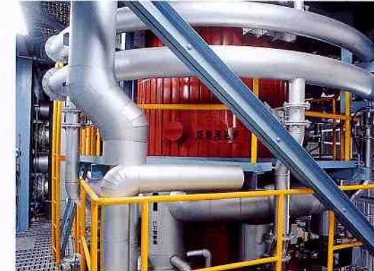
燃焼溶融炉 熱分解ガスとカーボンにより約1300℃の高温で完全燃焼させ、溶融スラグを作ります。
