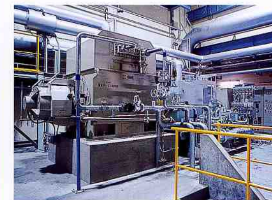
蒸気タービン・発電機 廃熱ボイラで発生した蒸気を利用して蒸気タービンを動かし発電します。
