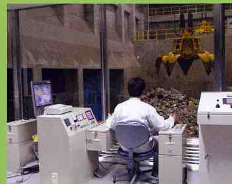
クレーン操作室 ごみピットに貯留されたごみをクレーンを操作してホッパへ投入します。
