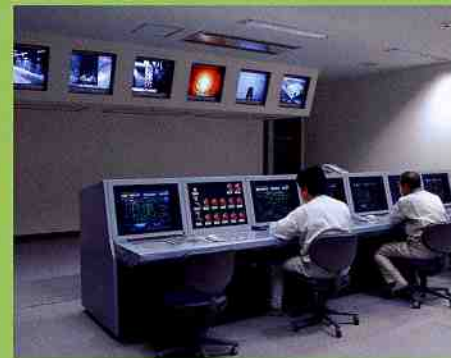
中央操作室 ごみ熱分解・燃焼溶融施設にある機器の運転状況を監視・操作するところです。
