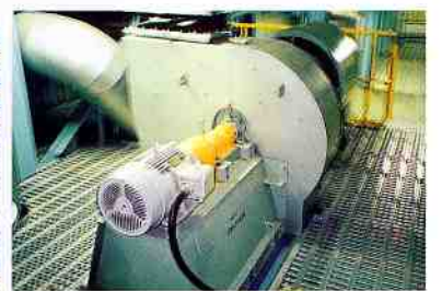
白煙防止用送風機 蒸気を使用して加熱した空気を排ガスに混合し、白煙の発生を防止します。
