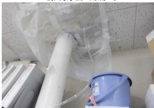
《教育庁舎 雨漏り》
