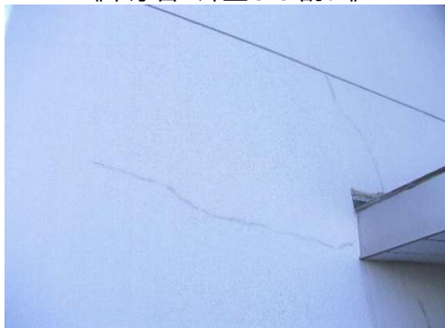
《本庁舎 外壁ひび割れ》
