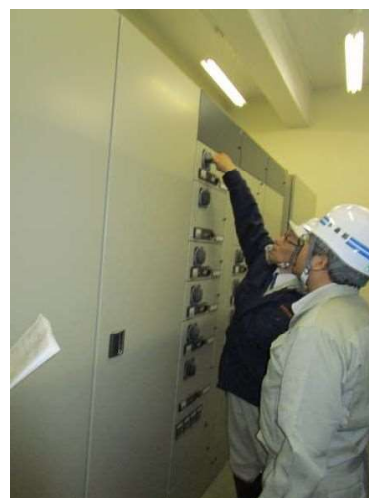
写真 5-3【機器制御盤の点検】
