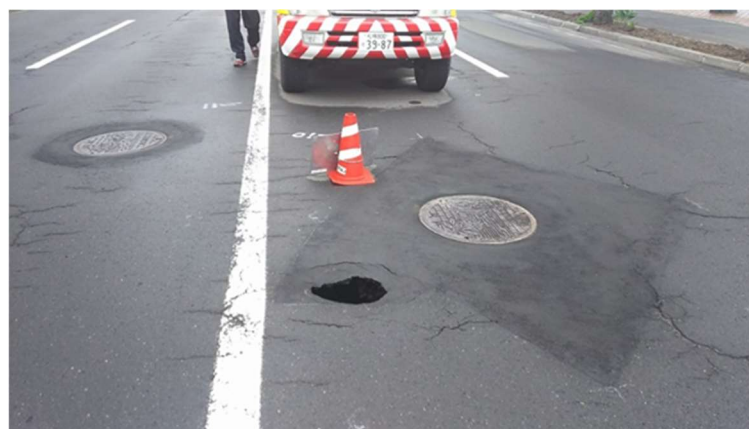
写真 3-3 【市内で発生した陥没状況】
