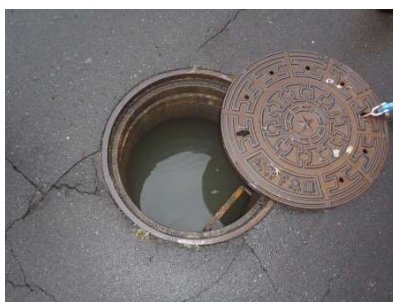
写真 3-9 【污水管が不明水により浸った状況】
