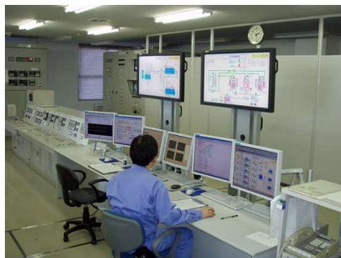
写真 7-4【配水状態の監視】
