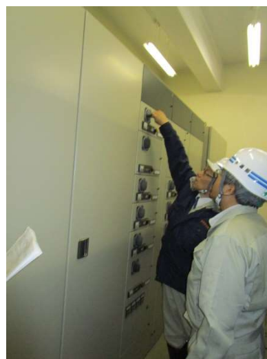
写真 5-3【機器制御盤の点検】
