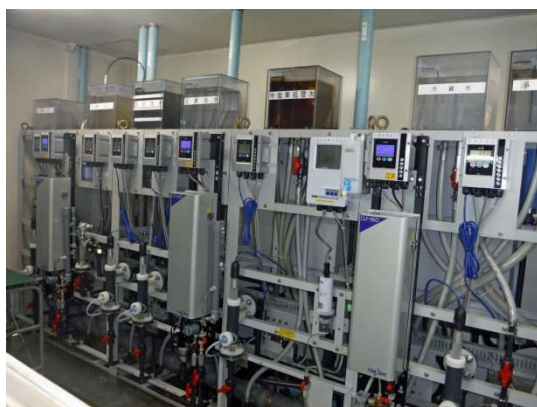
写真 3-6【水質監視計器】
