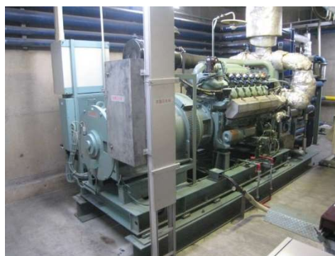
写真 7-13【消化ガスを燃料とした発電装置】
