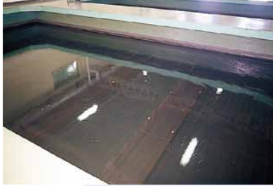
急速ろ過池 砂と砂利を敷きつめたろ過層に水を通すことで微少な不純物や濁りを取り除きます。
