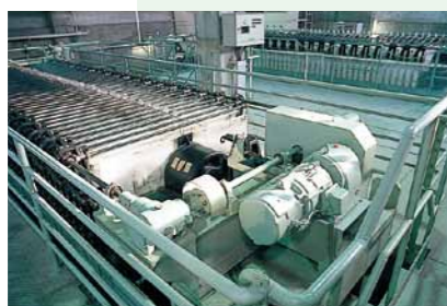
加圧脱水機 圧力を加え、泥の水分を取り除きます(これを脱水ケーキと呼びます)。
