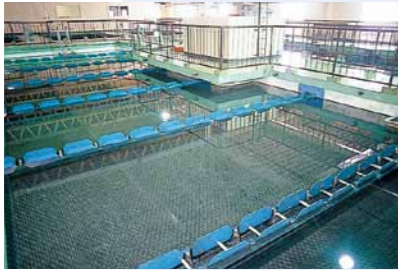
高速凝集沈殿池 原水中の濁りを凝集剤(硫酸アルミニウム)を使って沈殿させます。
