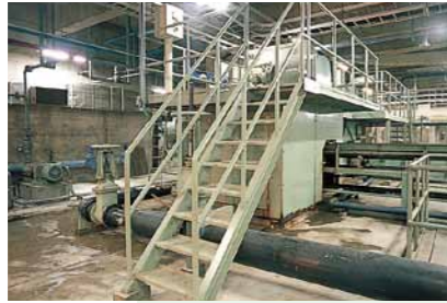
沈砂池 下水の中に含まれている大きなゴミや土砂を取り除きます。
