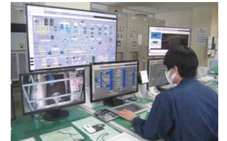
中央管理室 浄化センターやポンプ場の集中管理を行っています。
