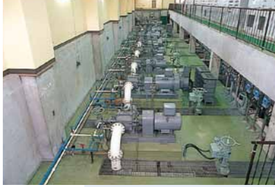
配水ポンプ きれいになった水道水を皆さまのご家庭に送ります。
