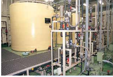
次亜塩素酸ナトリウム注入装置 安全な飲み水にするため塩素を注入します。トリハロメタンの生成を抑えるため、中間塩素処理に変更しました。
