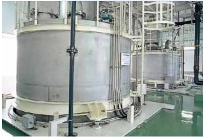
粉末活性炭貯留槽 タンクローリーで搬入した粉末活性炭を貯めています。
