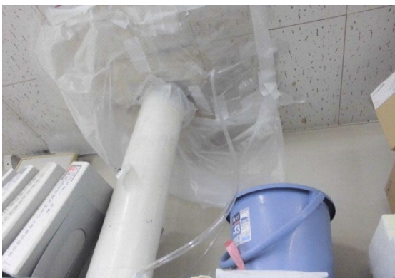
〈教育庁舎 雨漏り〉
