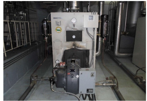
〈本庁舎 暖房ボイラー〉
