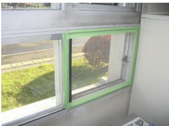
〈本庁舎 内部窓枠の歪み〉
