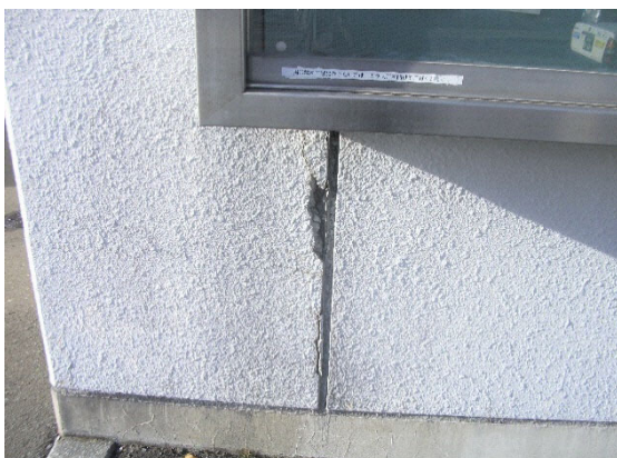
〈本庁舎 外壁剥離〉
