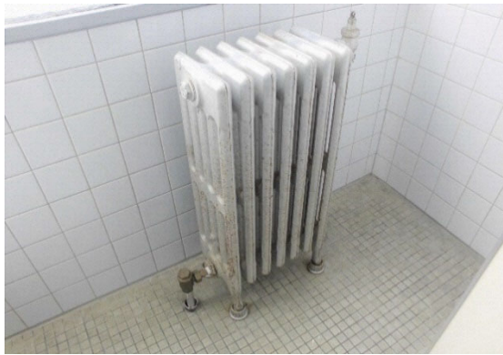
〈本庁舎 トイレ内暖房設備〉
