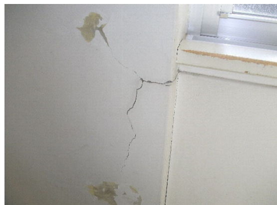
〈本庁舎 内壁ひび割れ〉
