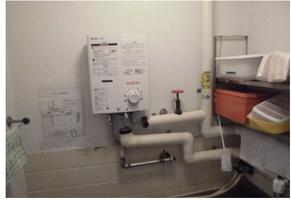
〈本庁舎 給湯器〉
