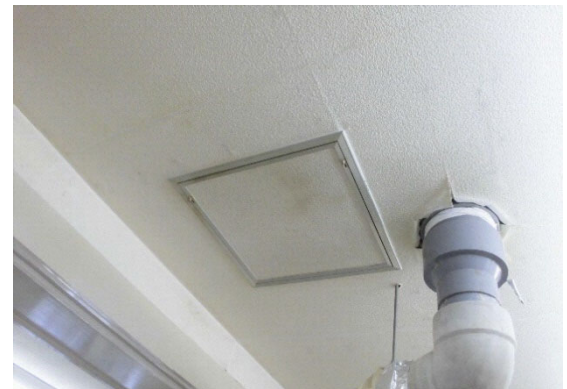
〈別館 天井クロス剥がれ・配管露出〉
