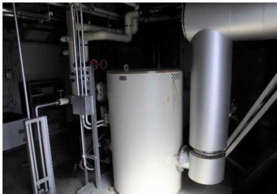
〈別館 暖房ボイラー〉
