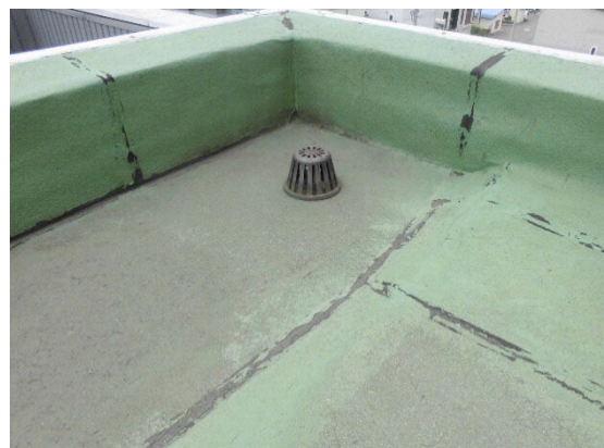
〈本庁舎 屋上防水の劣化〉
