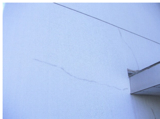
〈本庁舎 外壁ひび割れ〉
