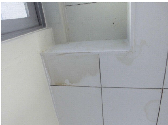
〈本庁舎 漏水跡〉
