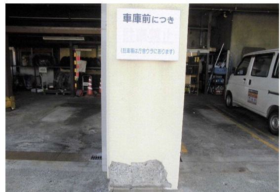
〈教育庁舎 外壁剥がれ〉
