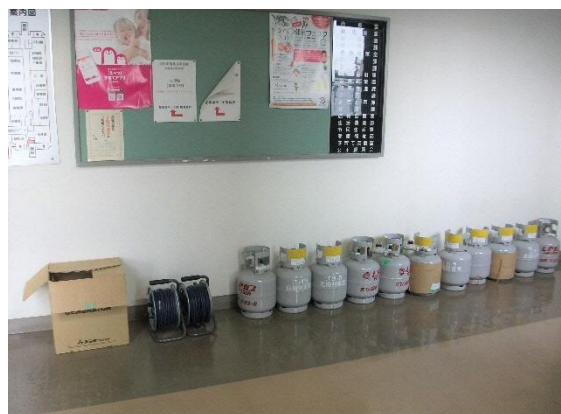
〈非常時発電備蓄品の様子〉
