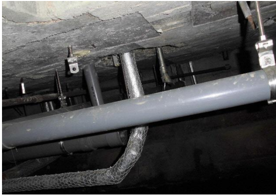
〈本庁舎 給排水設備〉
