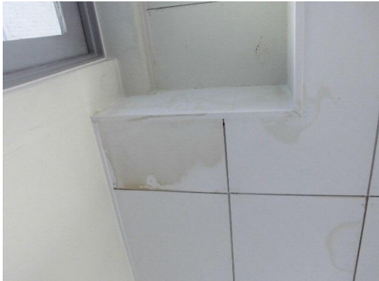
〈本庁舎 漏水跡〉
