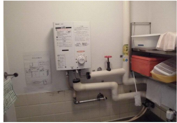
〈本庁舎 給湯器〉
