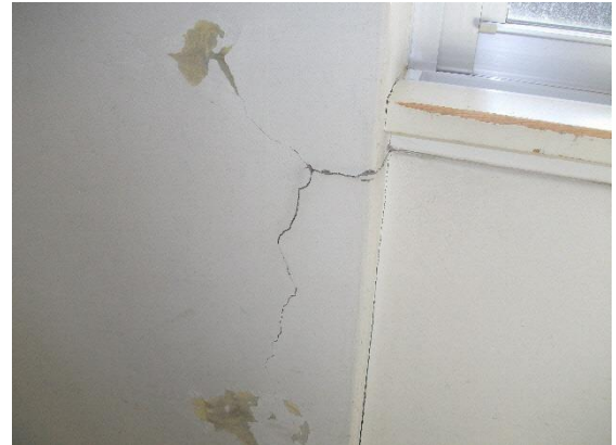
〈本庁舎 内壁ひび割れ〉
