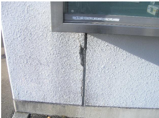
〈本庁舎 外壁剥離〉
