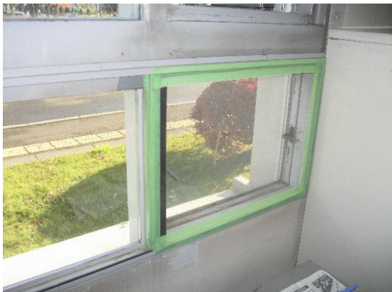
〈本庁舎 内部窓枠の歪み〉
