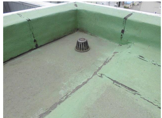
〈本庁舎 屋上防水の劣化〉
