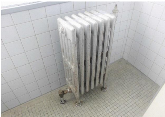
〈本庁舎 トイレ内暖房設備〉
