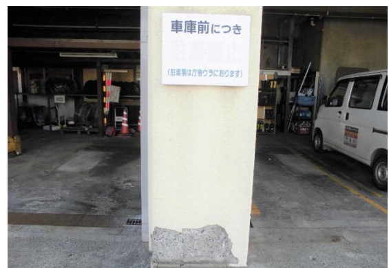
〈教育庁舎 外壁剥がれ〉
