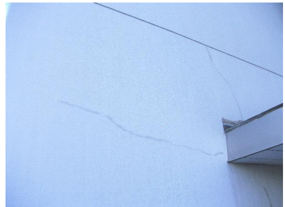
〈本庁舎 外壁ひび割れ〉
