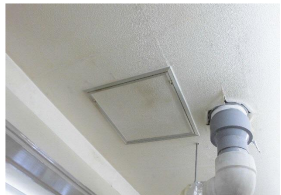
〈別館 天井クロス剥がれ・配管露出〉
