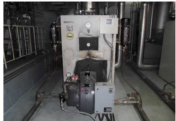
〈本庁舎 暖房ボイラー〉
