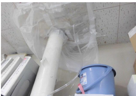
〈教育庁舎 雨漏り〉
