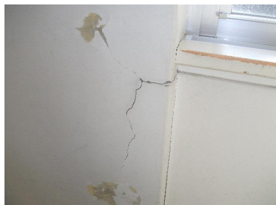
〈本庁舎 内壁ひび割れ〉
