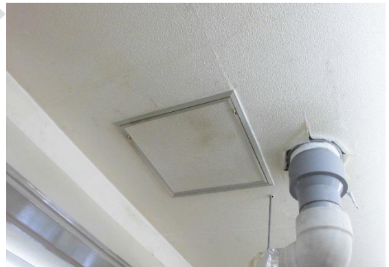
〈別館 天井クロス剥がれ・配管露出〉
