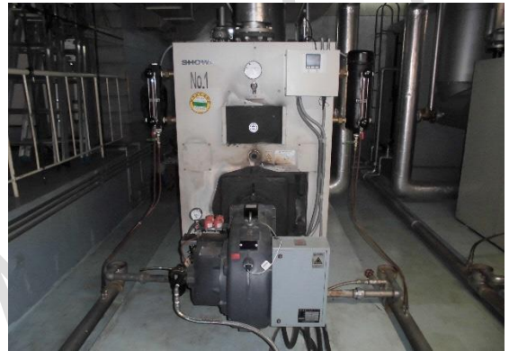
〈本庁舎 暖房ボイラー〉
