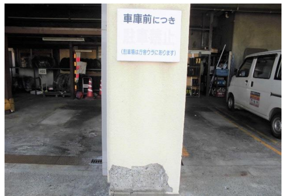
〈教育庁舎 外壁剥がれ〉
