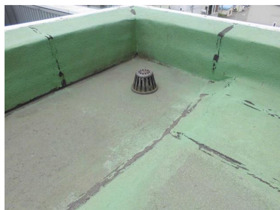
〈本庁舎 屋上防水の劣化〉
