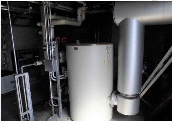
〈別館 暖房ボイラー〉
