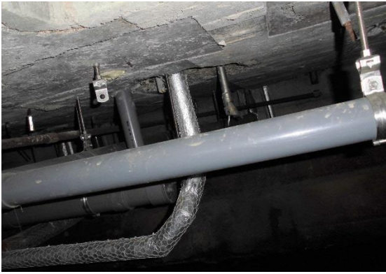
〈本庁舎 給排水設備〉
