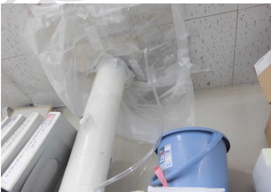
〈教育庁舎 雨漏り〉
