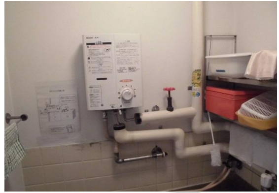
〈本庁舎 給湯器〉
