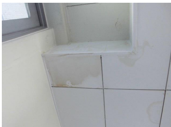
〈本庁舎 漏水跡〉
