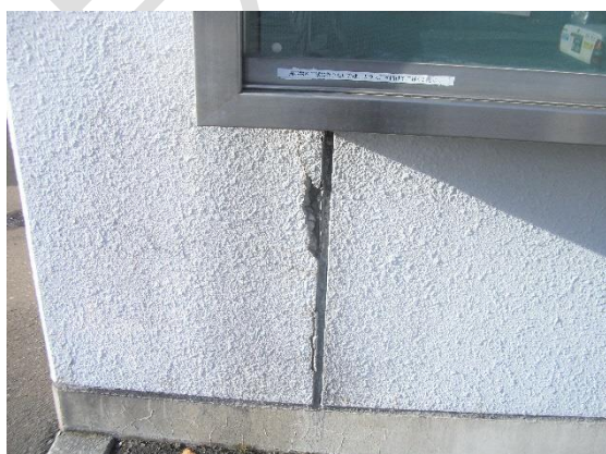
〈本庁舎 外壁剥離〉
