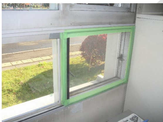
〈本庁舎 内部窓枠の歪み〉
