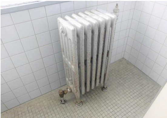
〈本庁舎 トイレ内暖房設備〉
