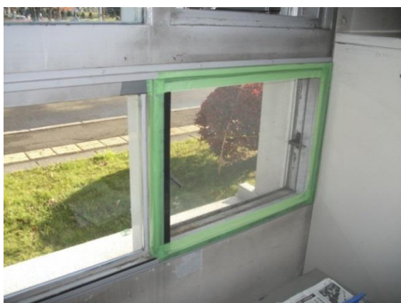
〈本庁舎 内部窓枠の歪み〉
