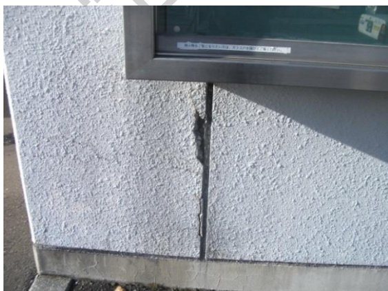
〈本庁舎 外壁剥離〉
