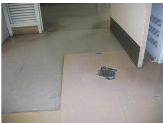
〈本庁舎 内部タイル剥がれ〉
