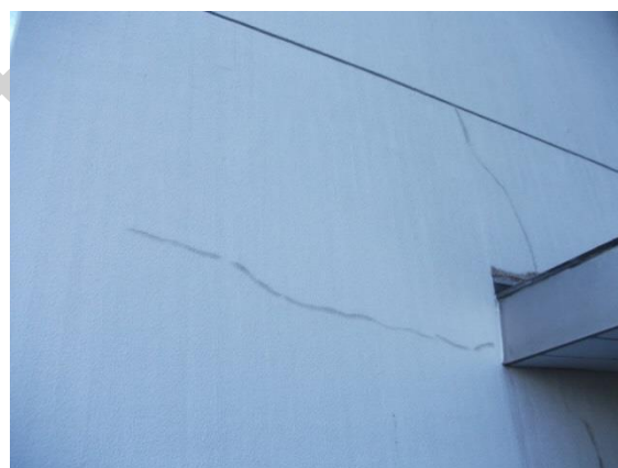
〈本庁舎 外壁ひび割れ〉
