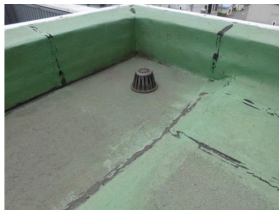
〈本庁舎 屋上防水の劣化〉
