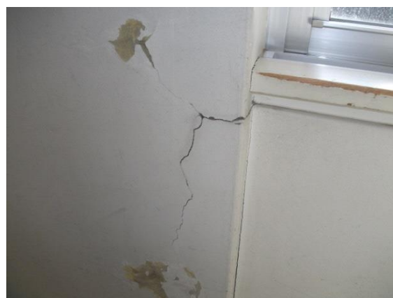
〈本庁舎 内壁ひび割れ〉
