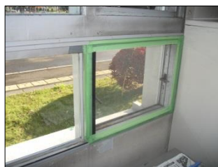
本庁舎 窓枠のゆがみ
