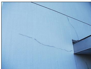
本庁舎外壁 ひび割れ
