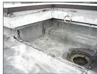
市民会館 屋上防水劣化
