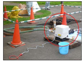
●緊急貯水槽用電動ポンプ
