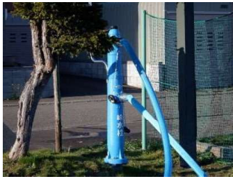
●災害時給水栓
