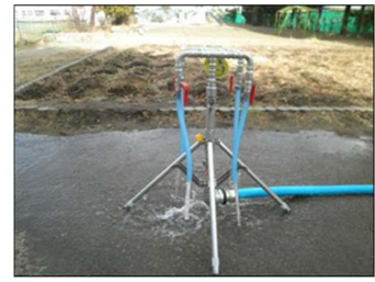
●消火栓用仮設給水栓
