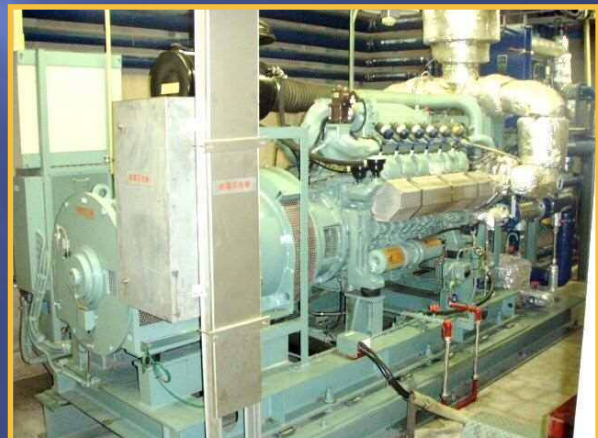
消化ガスエンジン
