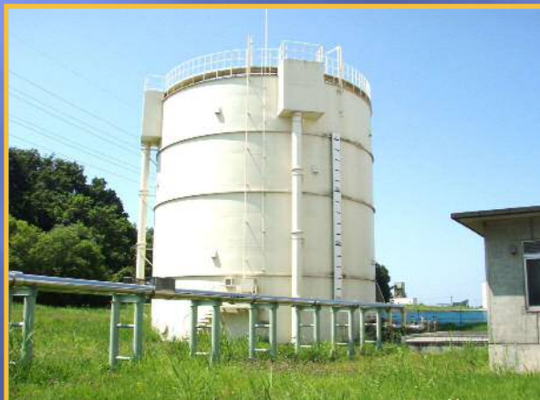
消化ガスタンク
