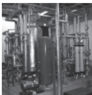
地下水の最新の浄水施設
