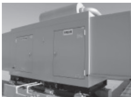
自家発電機は屋上に2台設置されている
