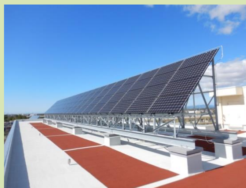
新栄団地E棟の太陽光発電設備（約20kW）
