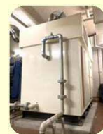
自家発電設備
