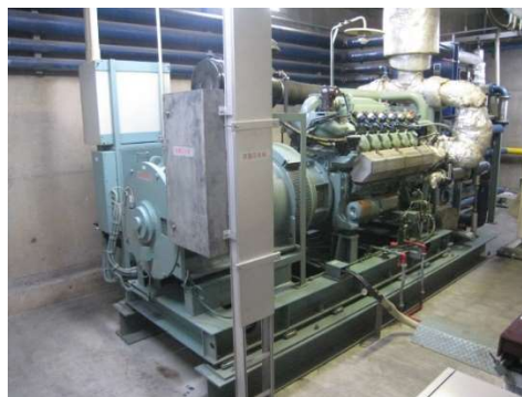
写真 7-13 【消化ガスを燃料とした発電装置】
