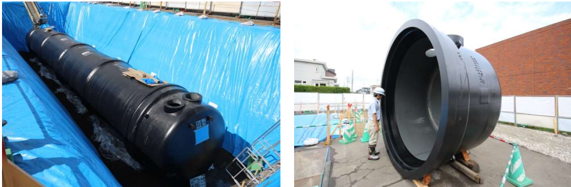
写真 7-7 【2017（平成 29）年度に対雁小学校に設置した緊急貯水槽 100 m級】
