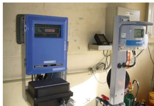
写真 7-1【水質連続監視装置(濁度計)】
