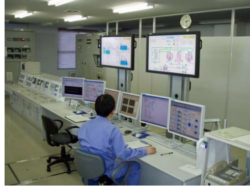
写真 7-4【配水状態の監視】
