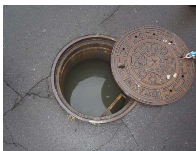
写真 3-9 【汚水管が不明水により浸った状況】
