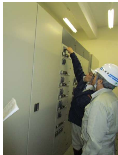
写真 5-3 【機器制御盤の点検】
