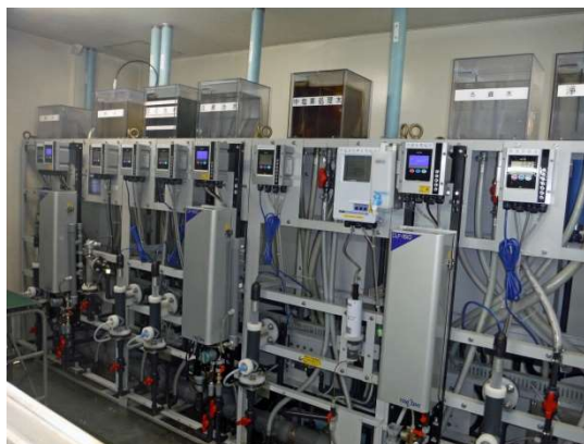
写真 3-6【水質監視計器】
