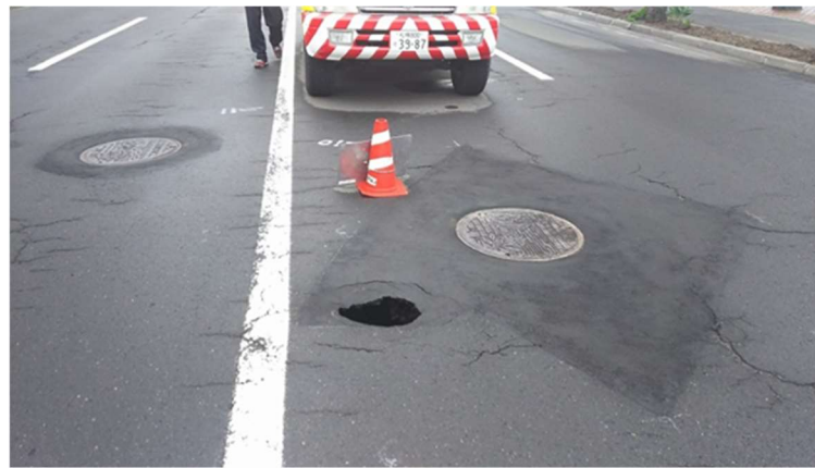
写真 3-3 【市内で発生した陥没状況】
