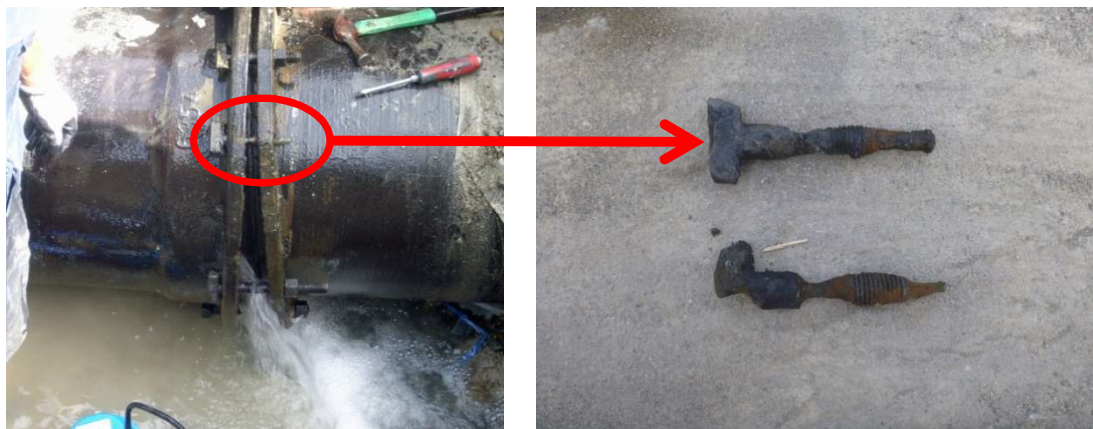
写真 3-2 【ボルト腐食による管継手からの漏水状況（左）と腐食したボルト（右）】
