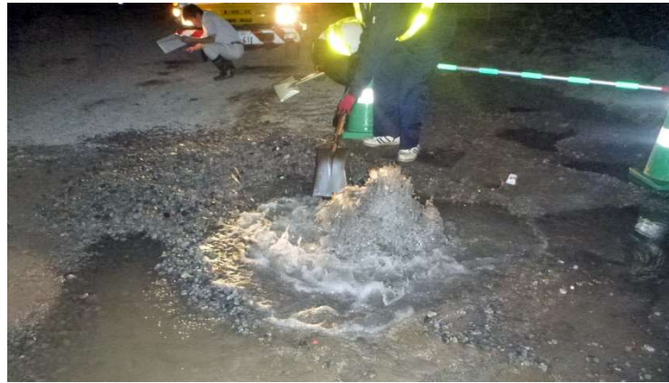
写真 3-1 【漏水が原因で地中から溢れる水道水】
