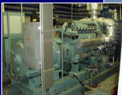
消化ガスエンジン
