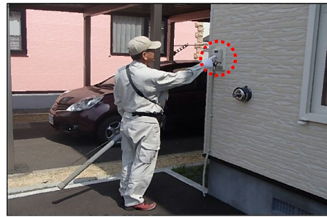
壁面に設置されている表示カウンタで検針
