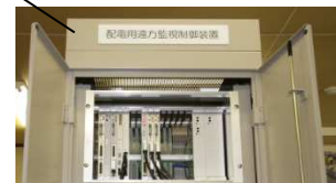
配電用遠方監視制御装置
