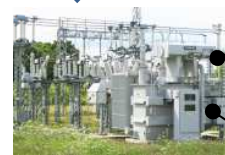
配電用変電所
