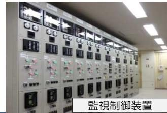
監視制御装置
