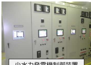
小水力発電機制御装置
