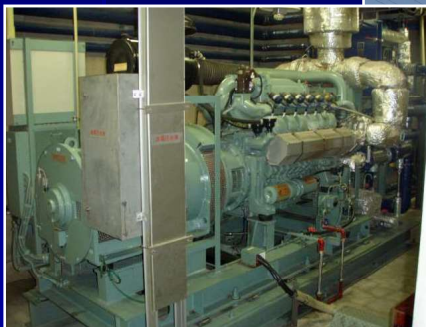
消化ガスエンジン
