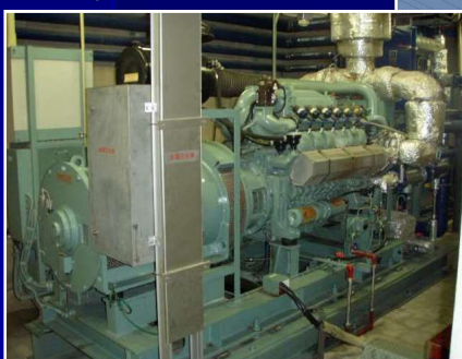
消化ガスエンジン
