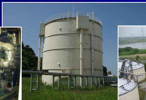
消化ガスタンク
