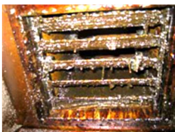
油脂で固着したダンパー
