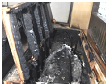
床下配置のダクト周囲 からの出火事例
