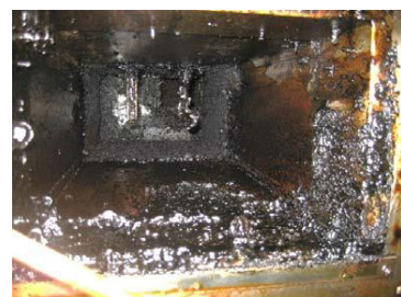
ダクト内に堆積した油脂
