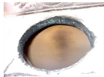
ダクトの壁面貫通部が 遮熱不良で炭化
